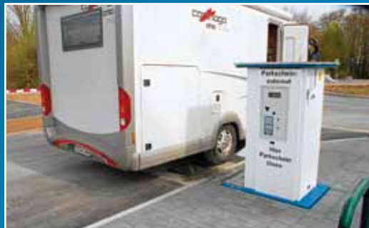
Die vorbildliche Servicestation in Grafenheinfeld übernimmt mit Parkscheinautomat auch die Kassenfunktion.
